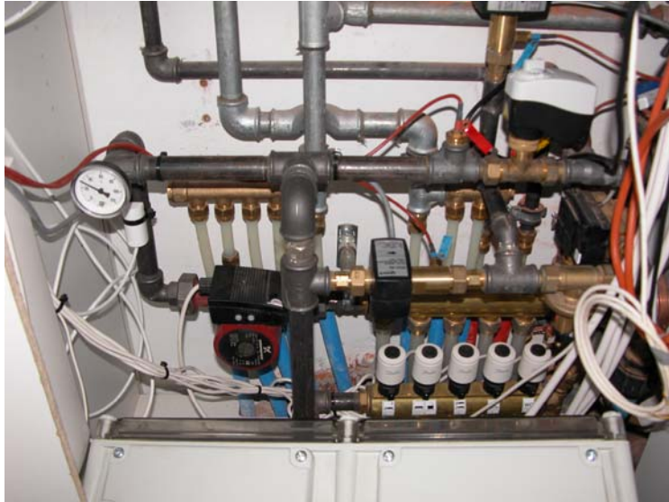
Figur 9. Billede af varmeinstallationen, der viser blandesløjfe, blandeventil (øverst til højre), pumpe og energimålerens flowmålerdel og temperaturfølere.
